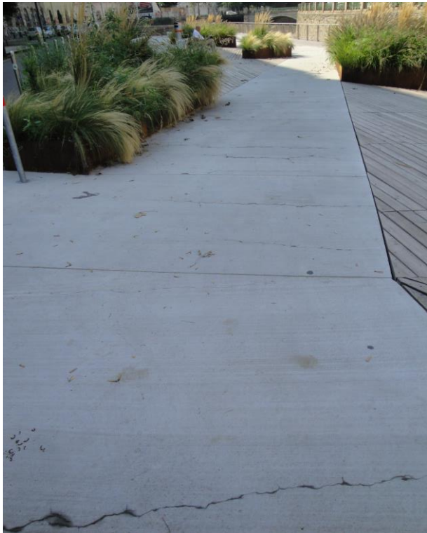
Abbildungen 6 und 7: Risse in den Betonfeldern
