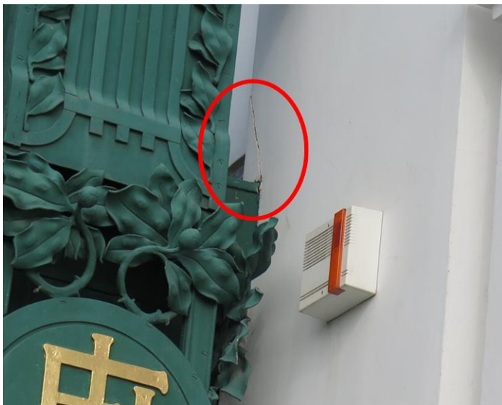
Abbildung 4: Riss im Verputz
