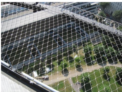
Abbildung 1: Absturzsicherung an einer Hubschrauberlandefläche
