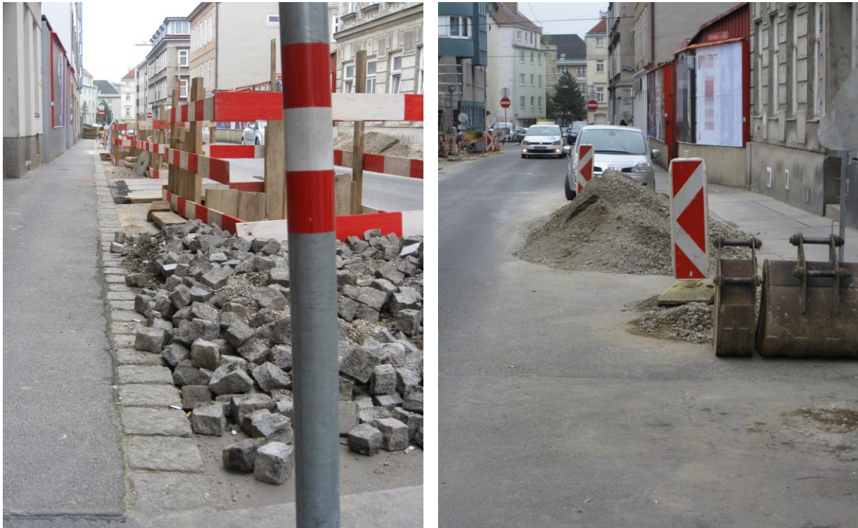
Abbildungen 5 und 6: Ungenügend abgesicherte Materiallagerungen
