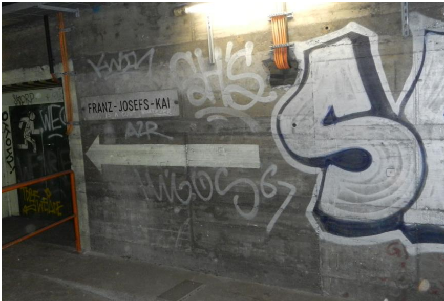
Abbildung 1: Graffitis beim Notausgang der U-Bahn im Bereich der Station Schottenring
