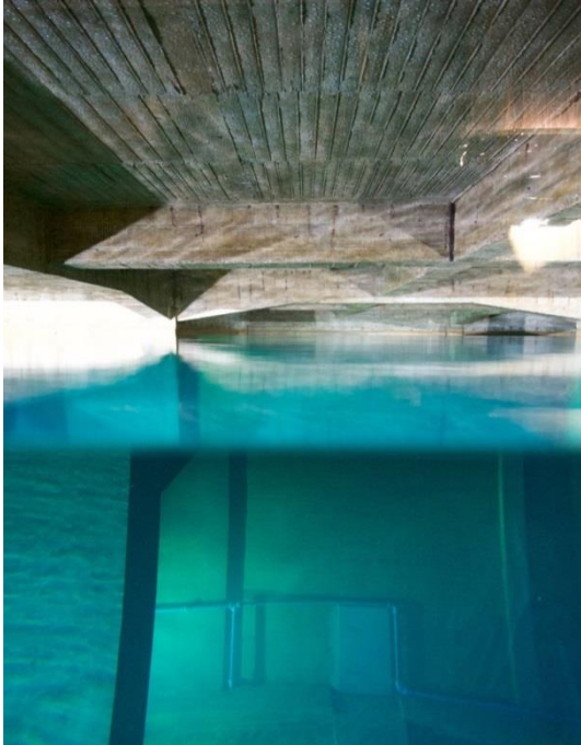
Abbildung 2: Gefüllter Wasserbehälter (fotografiert durch ein Schauglas)
