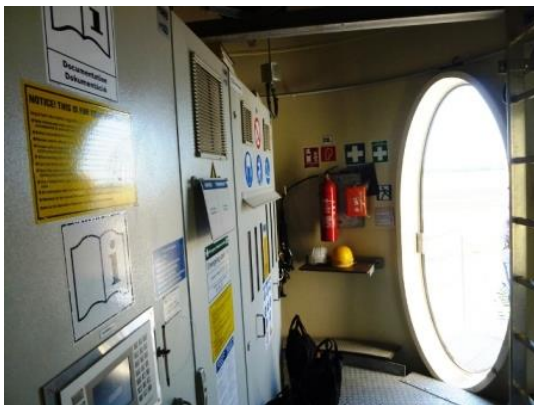
Abb. 6 - Steuerung- und Überwachungsanlage
