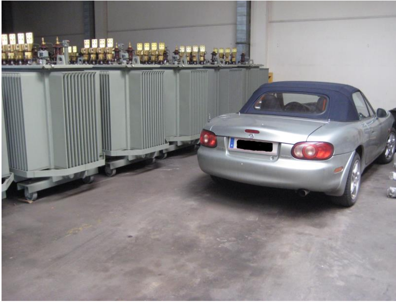
Foto 3: Nicht erlaubtes Parken eines privaten Fahrzeuges in einer Lagerhalle des BGS
