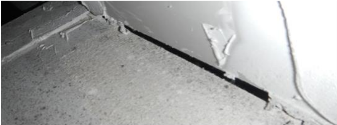
Abbildung 1: Offener Spalt im Bereich der Umhüllung der Aluminium-Stromschiene
