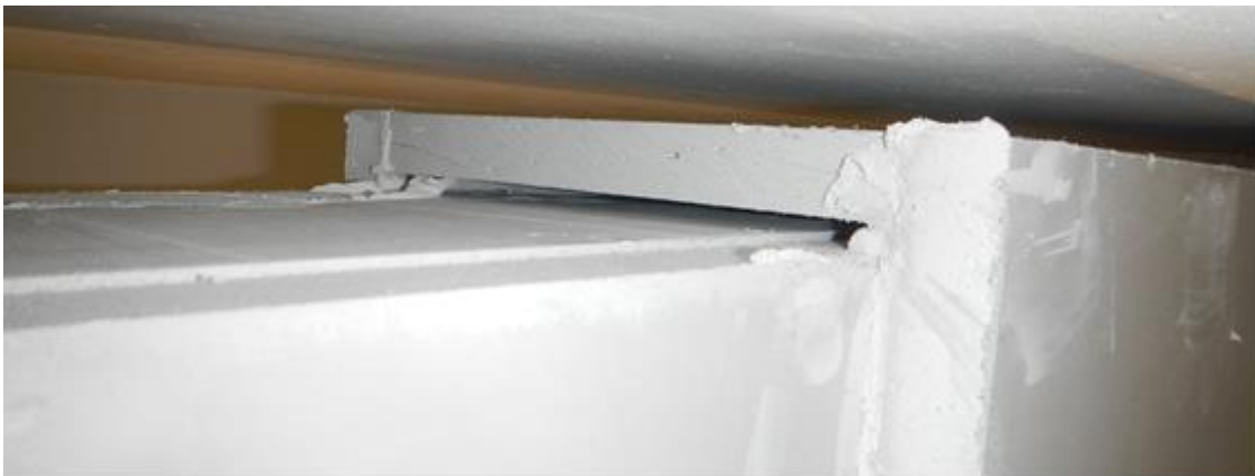
Abbildung 2: Offener Spalt im Bereich der Umhüllung der Aluminium-Stromschiene
