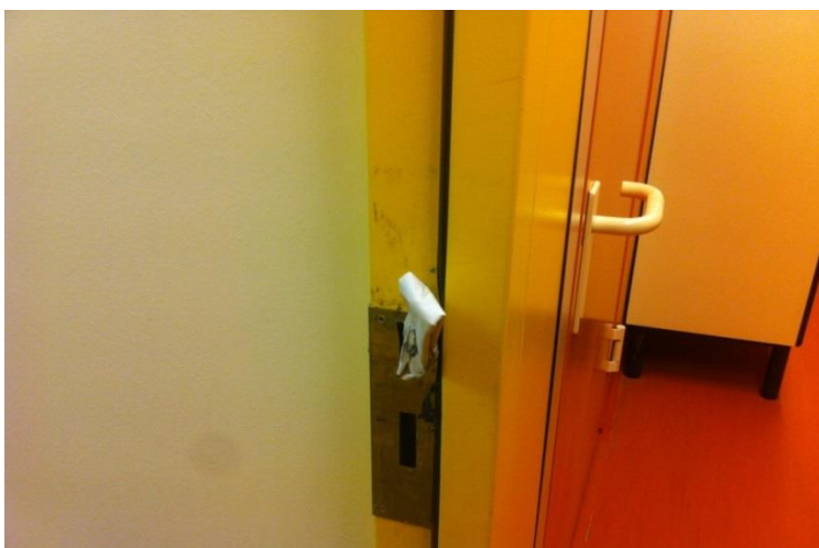
Abbildung 1: Blockade des Schließmechanismus einer Brandschutztür
