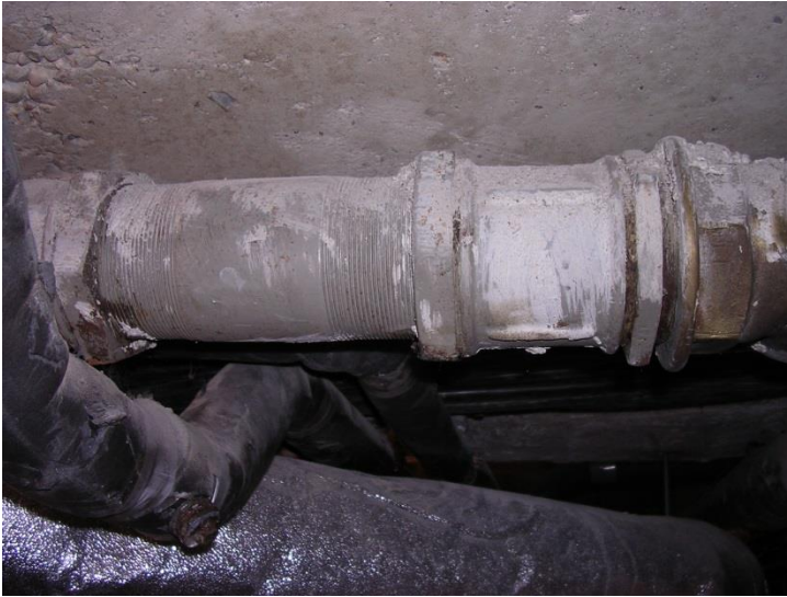
Abbildung 1: Langgewinde einer Gasleitung
