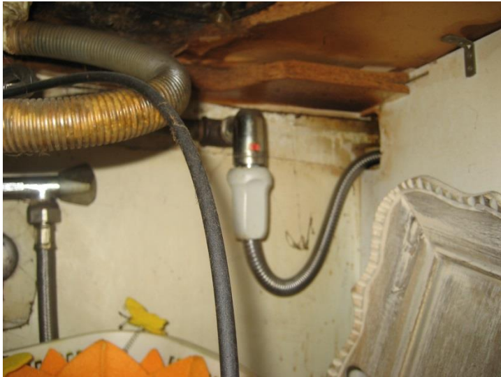
Abbildung 2: Gassteckdose mit flexibler Gasanschlussleitung
