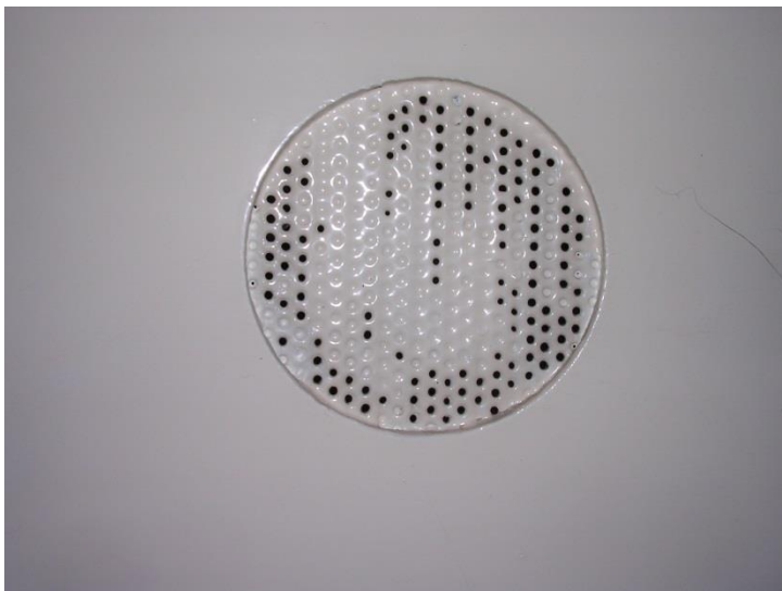
Abbildung 4: Mit Farbe verklebte Entlüftungsöffnung im Türblatt der Zählernische
