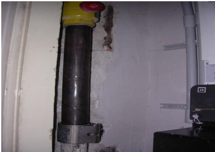
Abbildung 5: Gegen Korrosion ungeschütztes Gasrohr nach Austausch der Langgewindeverbindung
