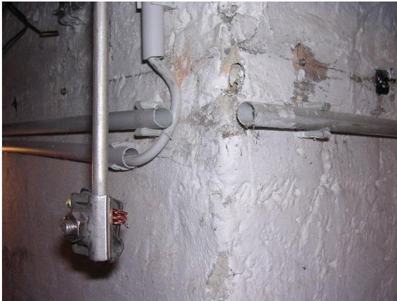
Abbildung 6: Erdungskabel der Gasleitungen gekappt bzw. entfernt
