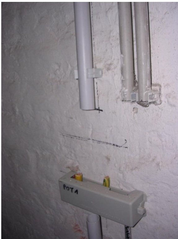
Abbildung 7: Erdungskabel an Potenzialausgleichsschiene gekappt bzw. entfernt
