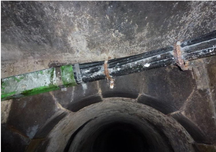
Abbildung 12: Lichtwellenleitertrasse mit angerosteten Sicherungsbügeln
