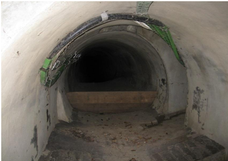
Abbildung 9: Lichtwellenleitertrasse im Bereich des Kämpfers bzw. Kanalscheitels
