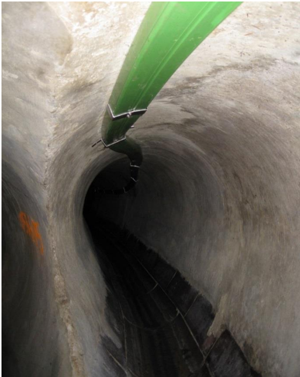
Abbildung 11: Lichtwellenleitertrasse am Kanalscheitel
