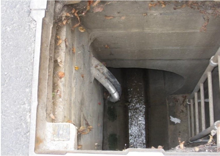
Abbildung 13: Einstiegschacht mit Hausanschluss
