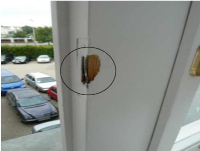
Abbildung 7: Beschädigung an Beschlagteil und Flügelholz
