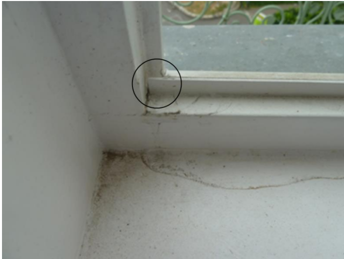
Abbildung 5: Spalt zwischen Regenschutzschiene und seitlichem Stockrahmen
