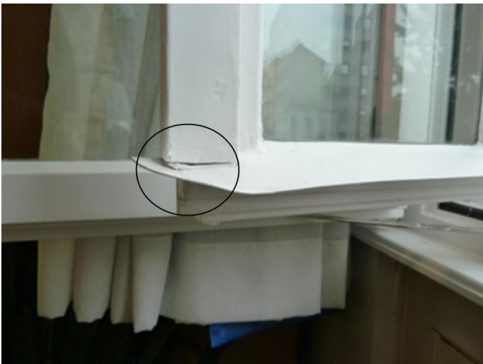
Abbildung 3: Deformierter Wetterschenkel mit Rissbildung
