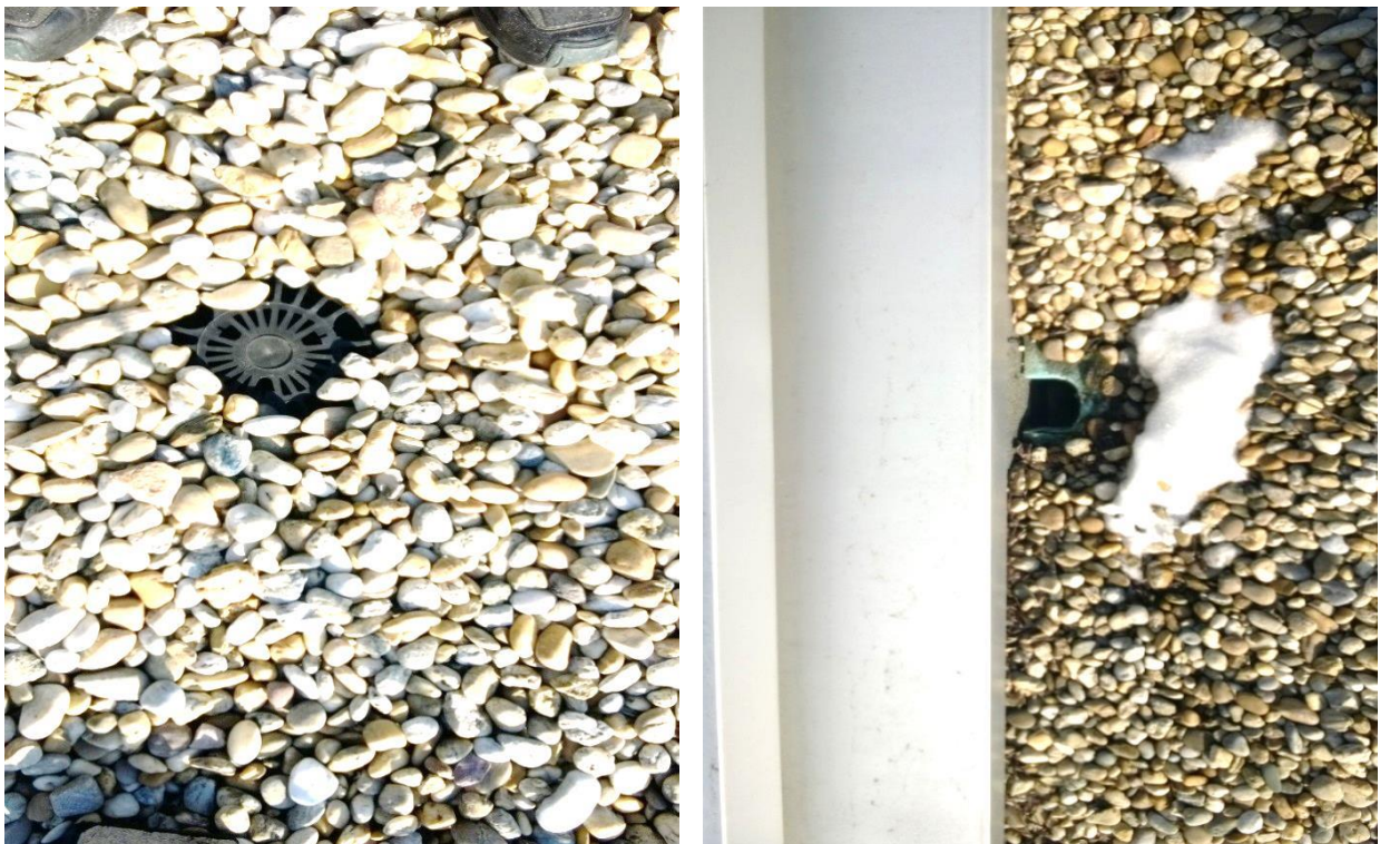
Abbildungen 4 und 5: Gully ohne Abdeckung und Öffnung im Flachdach
