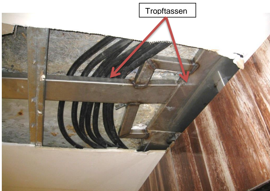
Abbildung 2: Untersicht Decke - Zusammenschluss zweier Tropftassen
