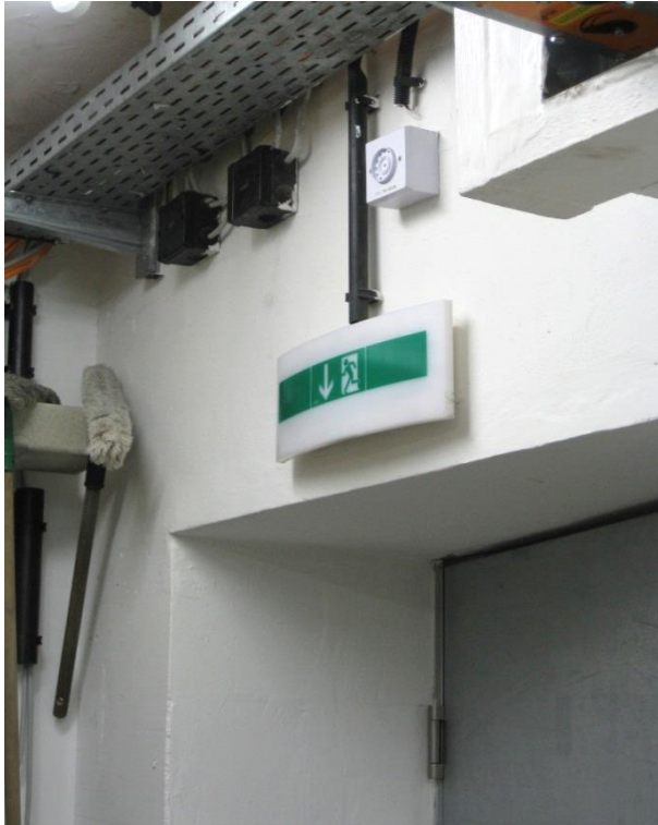
Abbildung 7: Notbeleuchtung in einem Dienstraum der Opernpassage
