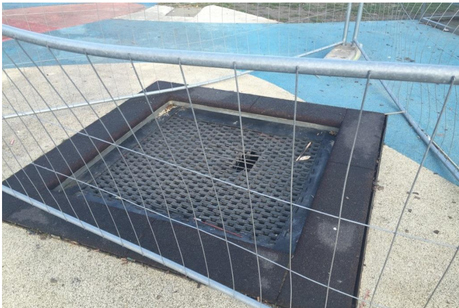
Abbildung 2: Defektes Trampolin am Wasserspielplatz Leberberg
