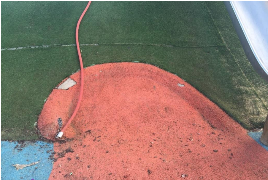
Abbildung 1: Mängel im Granulatbelag am Wasserspielplatz Leberberg
