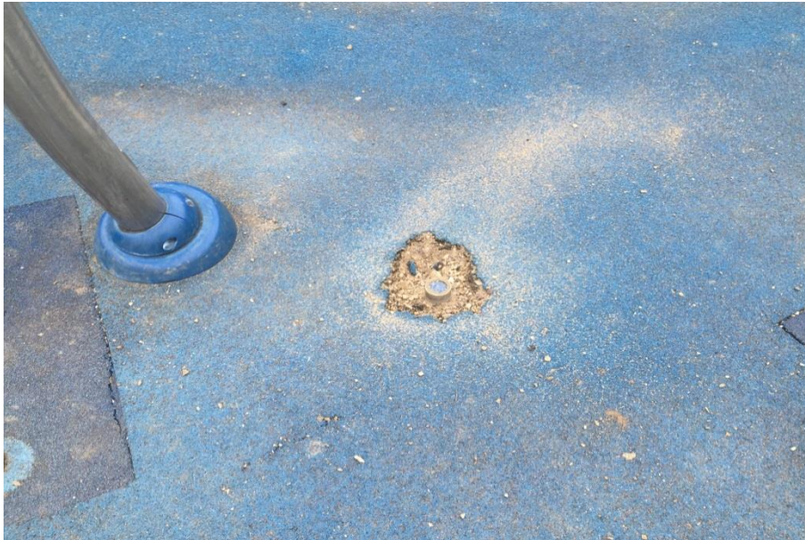
Abbildung 3: Mängel am Granulatbelag am Wasserspielplatz Max-Winter-Park
