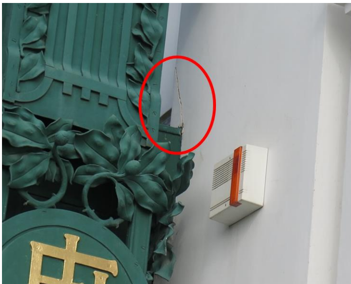
Abbildung 4: Riss im Verputz
