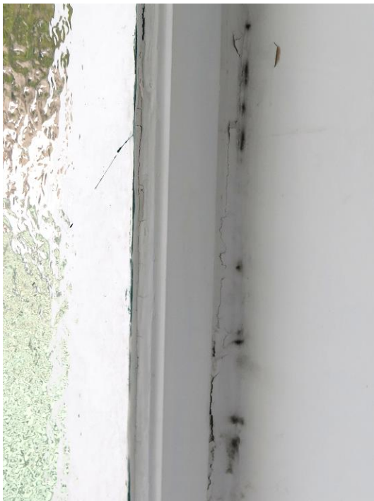
Abbildung 3: Abplatzungen der Beschichtung und Ansätze einer Schimmelbildung
