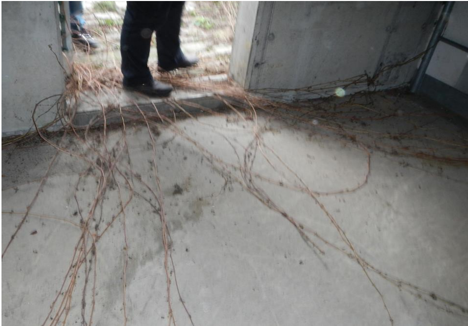
Abbildung 3: Ausläufer von Pflanzen, die in das Innere eines Lüftungsbauwerks vordringen
